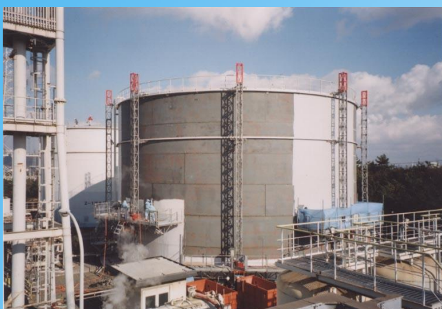
鋼製タンク外観
